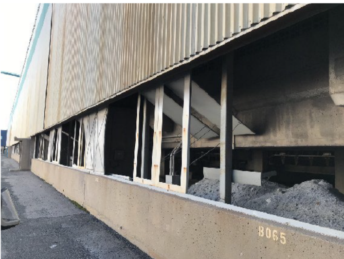
(photo 5) IMG_0674.JPG Poussière de bain visible sous les hall B et C
