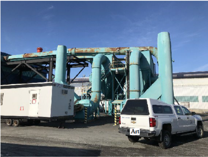
(photo 1) IMG_0671.JPG dépoussiéreur de l'écrémage des creusets
